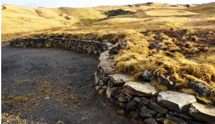
Banca para retener erosión y escurrimientos de agua en Geoparque Katla, Islandia © 2018 María Jesús May
